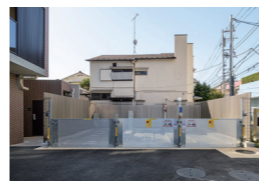
機械式駐車場
