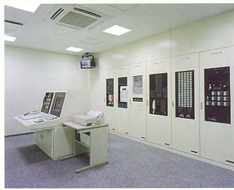
24時間体制の防災センター
